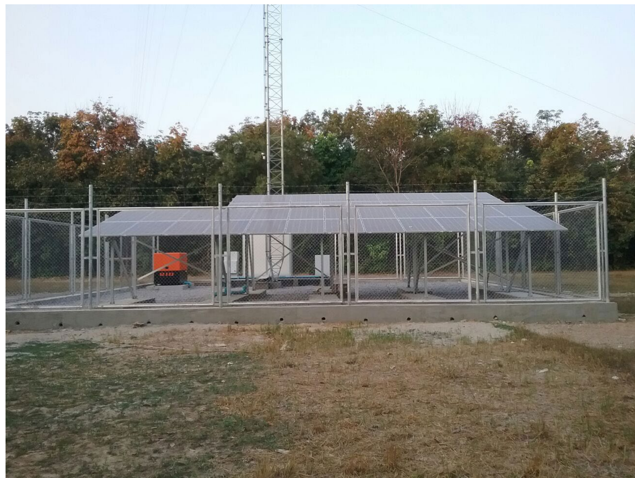
Гибридные электростанции RID для проекта телеком в Мьянме
